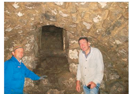
Abb. 4: Freilegung des Abgangs in den Keller, nur wenige Meter vom Dechantshof entfernt. Beteiligte Personen (von oben): Andreas Käferböck, Franz Mayrhofer (damals Stadtpfarrer), Klaus Elmecker, Otto Ruhsam.
