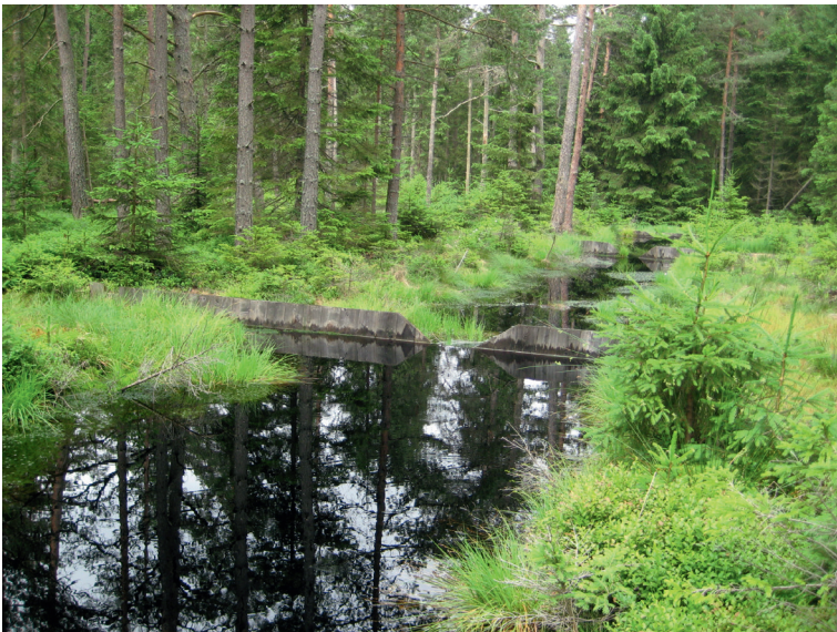
Abb. 3: Wasserstau durch die Sperranlagen.
